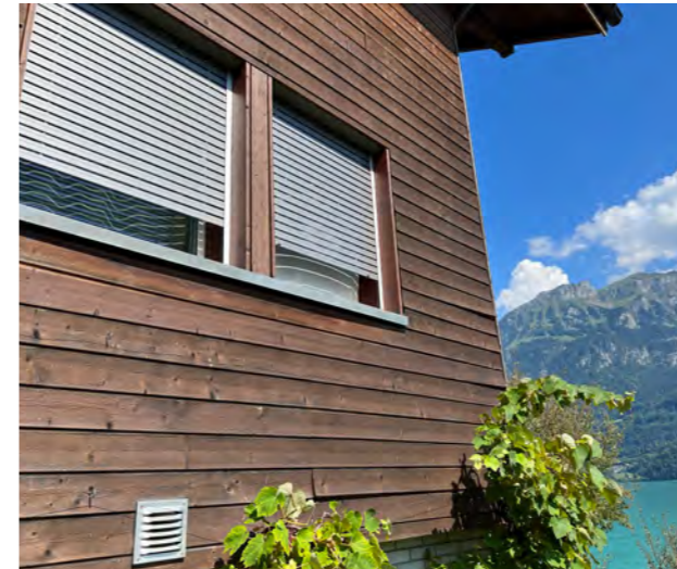
Ansicht Fassade mit Hagelschaden
