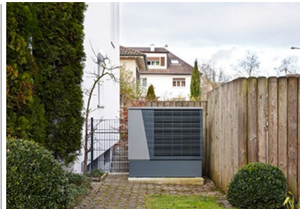
Aussen aufgestellte Luft-/Wasser-Wärmepumpe
