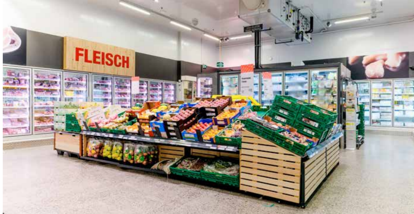
Der neue begehbare Kühlschrank nennt sich bei Growa Coolway.
