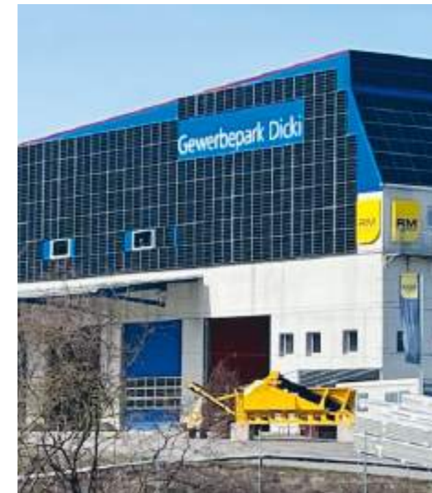
Fassade Industriebau in Hasle-Rüegsau (2024). Foto: SpiezSolar
