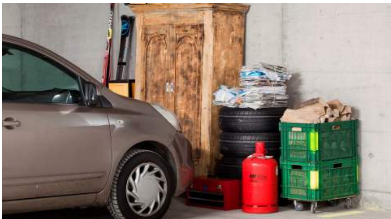
Schlechtes Beispiel einer Einstellhalle: versperrte Fluchtwege, gelagerte Materialien, welche die Brandgefahr erhöhen. Foto: Beratungsstelle für Brandverhütung BFB
