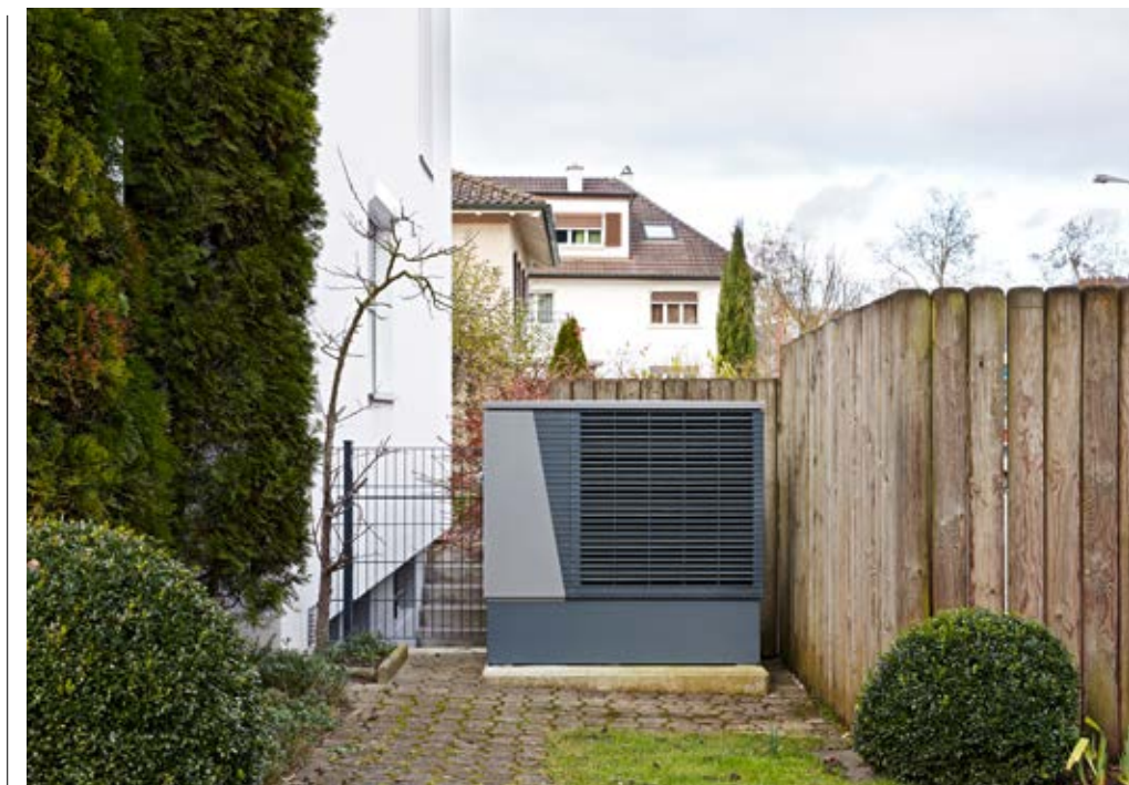
Aussen aufgestellte Luft-/Wasser-Wärmepumpe
