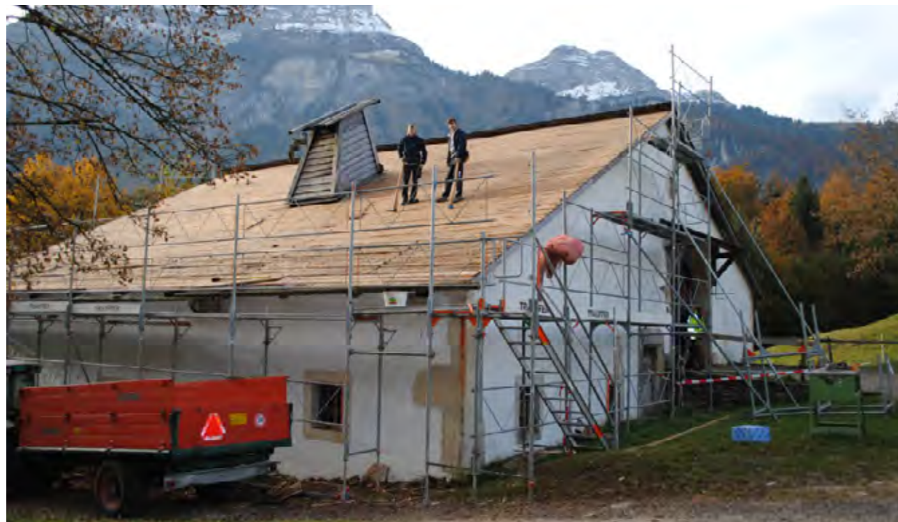
Timon Kappeler und Kenan Bürki auf dem Dach «La Chaux-de-Fonds» nach erfolgtem Abbruch.
