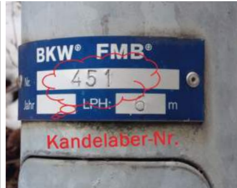
Die Kandelaber-Nummer ist auf einer Plakette am Mast der Strassenlampe abzulesen - sie ist bei der Behebung eines Schadens sehr hilfreich. Foto: zvg
