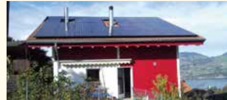
Eine der mittlerweile über 50 Anlagen der EWG
