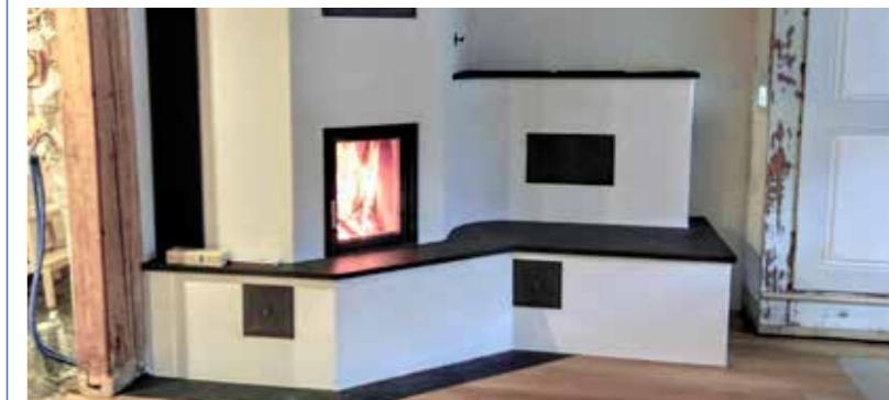
Speicherofen mit Kesseltechnik, Ganzhausheizung
