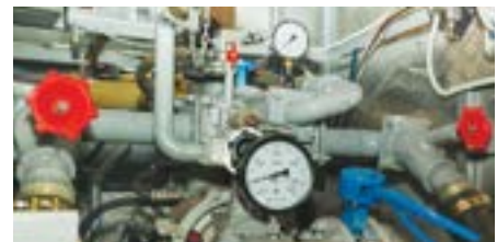
Pumpen und Ventilsteuerung
