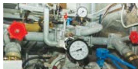
Controle de bomba e de válvula
