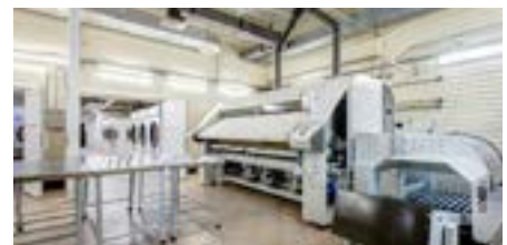
Sistema automatizado de lavanderia
