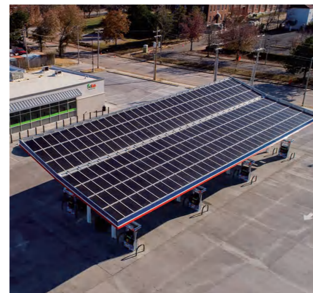
Projekt Tankstelle in Brazil 26kW
