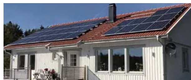
Wohnprojekt in Sweden 10kW
