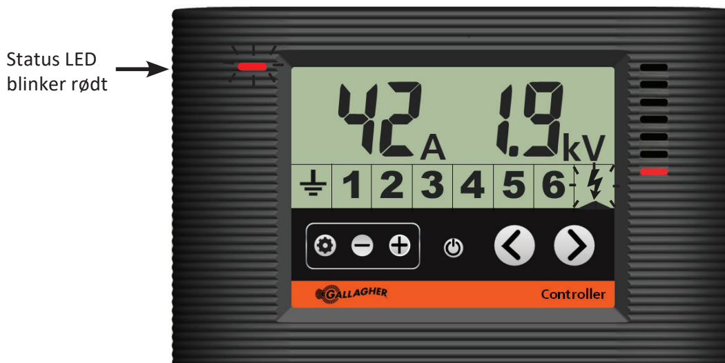
Styreenheden viser energizeren i strømstyrke alarm
