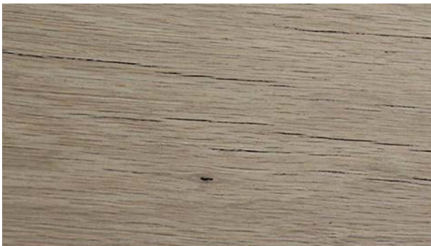
1. Hårtynne tørkesprekker i overflaten av eik. Disse små sprekkene vil kunne forsvinne ved høyere luftfuktighet.
