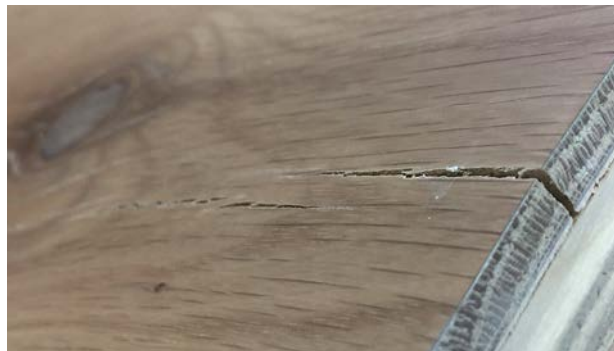
2. Større tørkesprekk i lakkert parkett. Lakken er perforert og gir ikke samme beskyttelse til området ved sprekken. Sprekker dannes typisk ved kortenden av bordene eller ved kvister. Man kan også se at eikefinéren begynner å slippe tak fra midtsjiktet (delaminering). Denne sprekkene vil ikke forsvinne men må utbedres.
