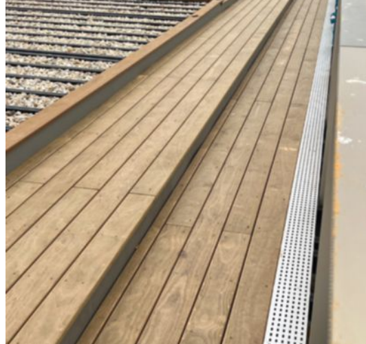
Die Aluminiumprofile mussten ausreichend hoch sein, um die Belüftung des Holzbelags sicherzustellen.
