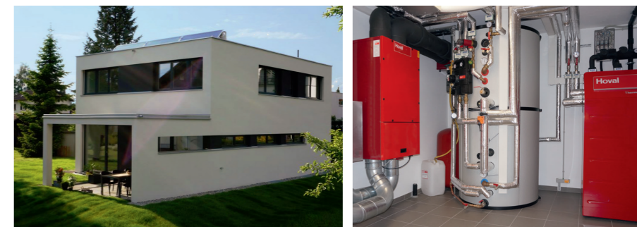
Ventilatia rezidentiale este o componenta importanta a sistemelor moderne de incalzire.
