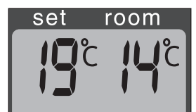
G: Vaadittu lämpötila vasemmalla, mitattu lämpötila oikealla.
