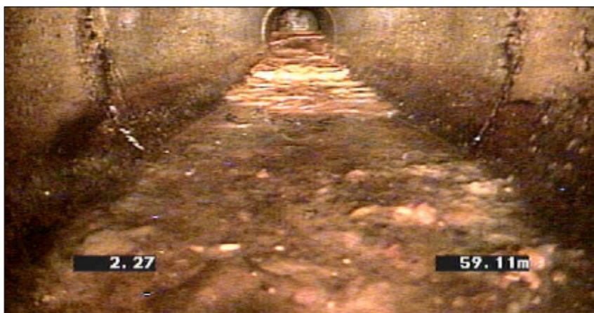
Figur 5-1 Sediment, finmaterial av grad 3 dokumenterat på en ledning som var funktionsklassad som "A". Ledningen är av betong med en dimension av 225 mm.
