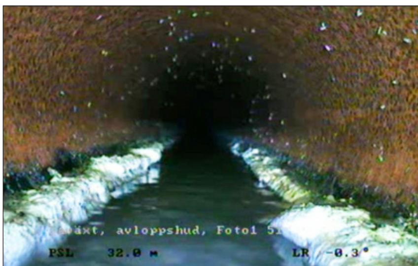
Figur 5-2 Vad som syns på bilden klassades av rörinspektör som biologisk påväxt, medan en annan inspektör istället tyckte att fett var en bättre benämning. Ledningen är av plast med en dimension av 200 mm.
