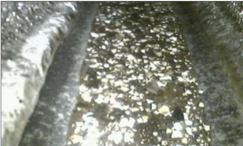
Figur 4-7. Typiska ansamlingar av äggskal tillsammans med annat finmaterial observerade i MAK-områden. Ledningen på bilden är av betong med en dimension av 225 mm.
