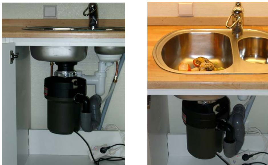
Figur 5.1 Försöksuppställning vid malförsök med installerad köksavfallskvarn.
