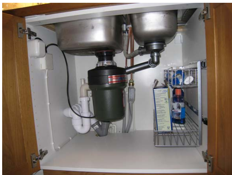
Figur 2 Köksavfallskvarn installerad i Järfälla kommun. Foto: Göran Engman, 2009
