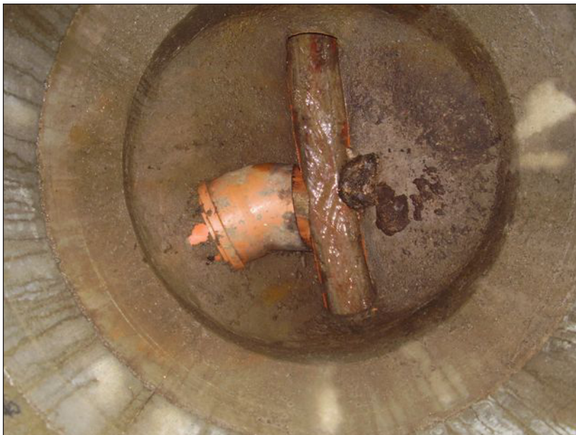
Figur 5.8 Bild på svartvattenledning i gårdsgata (160 mm) med inkommande servis från hus (110 mm). På bilden ser man den ingjutna ledningen i gårdsgatan som är uppskuren i övre kvartscirkeln.
