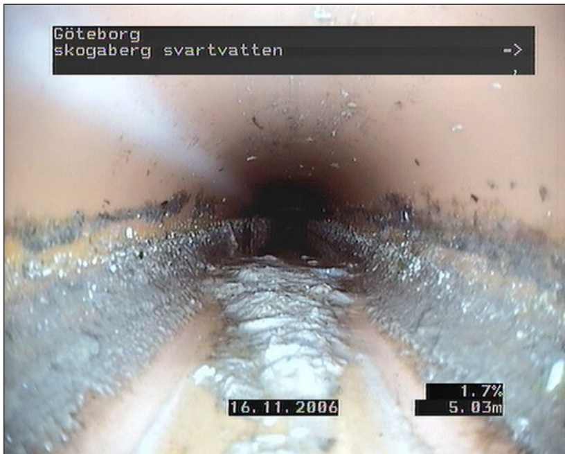
Figur 5.7 Bild på svartvattenledning med avlagring på rörväggen i höjd med vattengång.
