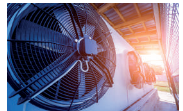
SISTEMAS DE VENTILACIÓN
