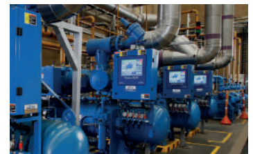
SISTEMAS DE BOMBEO
