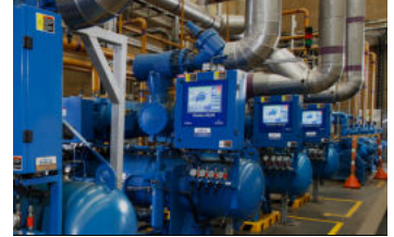
SISTEMAS DE REFRIGERACIÓN
