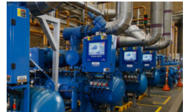
SISTEMAS DE REFRIGERACIÓN
