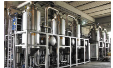
SISTEMAS DE TRATAMIENTO DE AGUAS RESIDUALES
