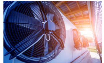
SISTEMAS DE VENTILACIÓN
