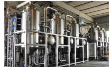
SISTEMAS DE TRATAMIENTO DE AGUAS RESIDUALES
