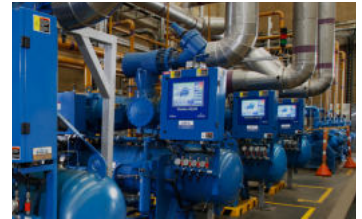
SISTEMAS DE REFRIGERACIÓN
