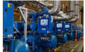
SISTEMAS DE REFRIGERACIÓN
