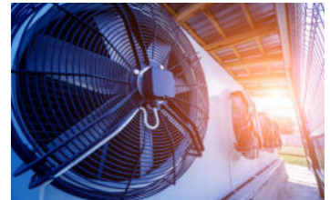
SISTEMAS DE VENTILACIÓN
