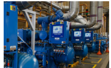
SISTEMAS DE REFRIGERACIÓN
