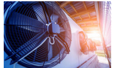
SISTEMAS DE VENTILACIÓN
