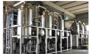
SISTEMAS DE TRATAMIENTO DE AGUAS RESIDUALES
