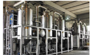
SISTEMAS DE TRATAMIENTO DE AGUAS RESIDUALES
