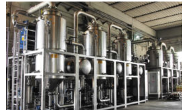
SISTEMAS DE TRATAMIENTO DE AGUAS RESIDUALES
