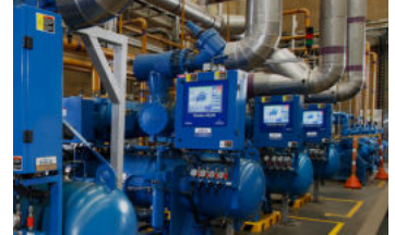
SISTEMAS DE REFRIGERACIÓN
