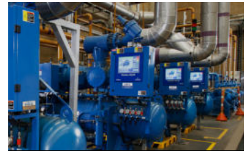
SISTEMAS DE REFRIGERACIÓN
