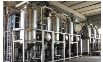
SISTEMAS DE TRATAMIENTO DE AGUAS RESIDUALES
