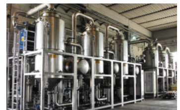
SISTEMAS DE TRATAMIENTO DE AGUAS RESIDUALES
