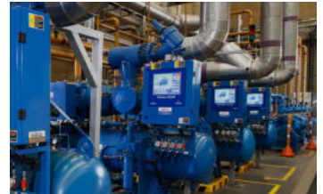
SISTEMAS DE REFRIGERACIÓN
