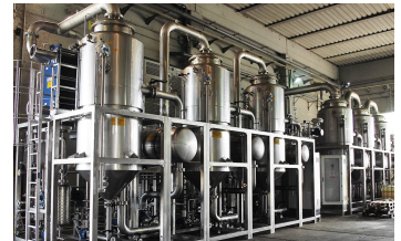
SISTEMAS DE TRATAMIENTO DE AGUAS RESIDUALES
