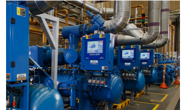
SISTEMAS DE REFRIGERACIÓN
