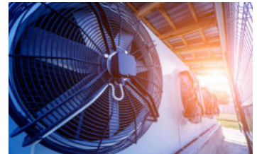
SISTEMAS DE VENTILACIÓN
