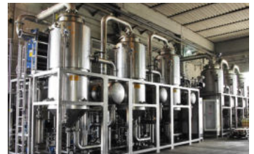
SISTEMAS DE TRATAMIENTO DE AGUAS RESIDUALES
