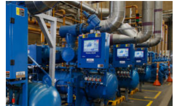
SISTEMAS DE REFRIGERACIÓN
