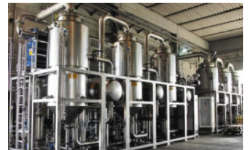
SISTEMAS DE TRATAMIENTO DE AGUAS RESIDUALES
