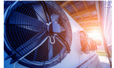
SISTEMAS DE VENTILACIÓN
