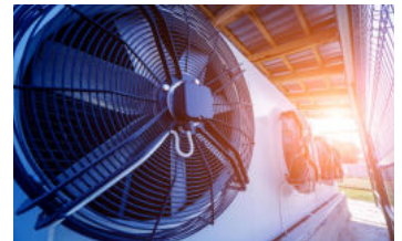
SISTEMAS DE VENTILACIÓN
