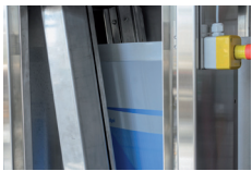
Air blower module
