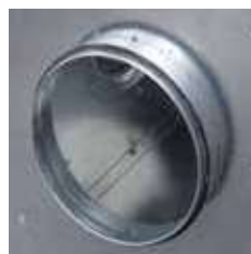
Juntas de estanqueidade nas bocas de aspiração.
