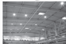
工場(高天井用LEDランプ)
