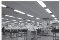
公共施設(直管LEDランプ)
