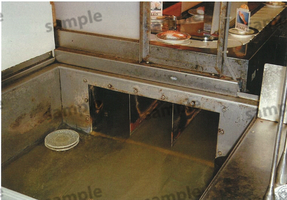
写真14 水回収システム (厨房開口部)
