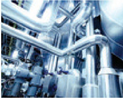
Entorno altamente corrosivo típico: planta central de servicios públicos
