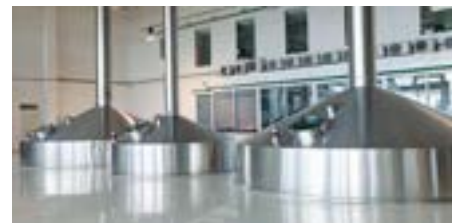
ビール醸造設備
