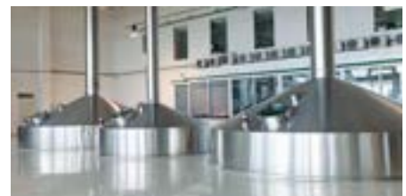
ビール醸造設備
